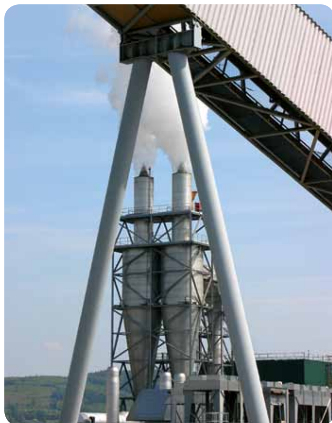
L'été, les ventilateurs ayant un débit limité, l'entrée de chaleur est restreinte et, par conséquent, la production maximale du séchoir.
